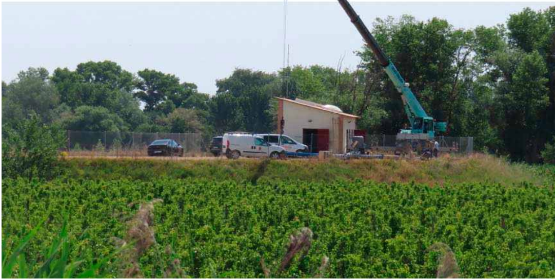
Operarios municipales y de una empresa especializada abordaron ayer, con la ayuda de una grúa, la rotura de la bomba en los pozos de captación. E. P.
